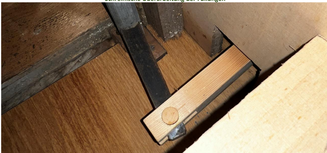
Abbildung 29 Schwellergestänge unter dem Podium
