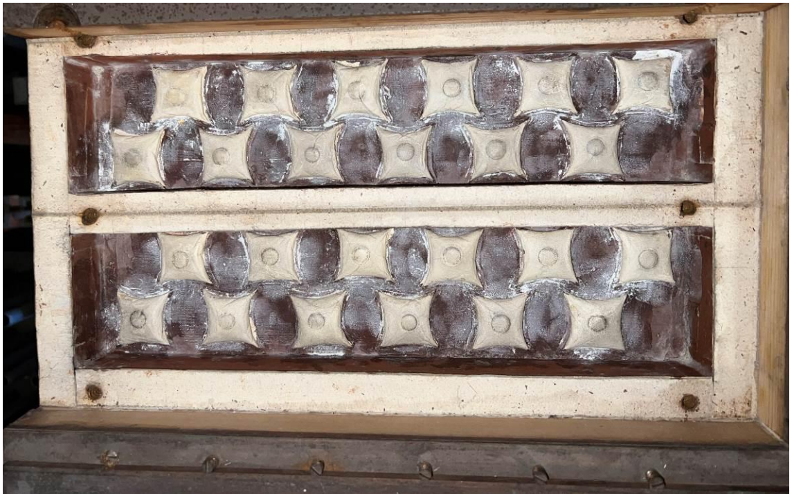
Abbildung 13 Blick auf die Tonmembranen vor der Renovierung
