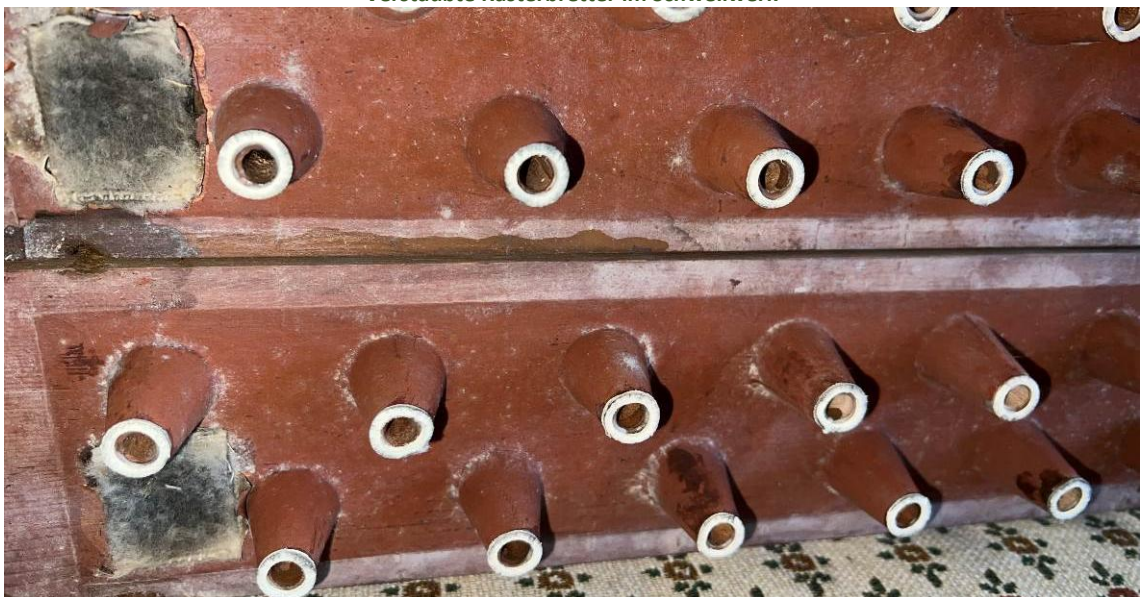
Abbildung 10 Stockunterseite mit Bolusanstrich und leichtem Schimmelbefall
